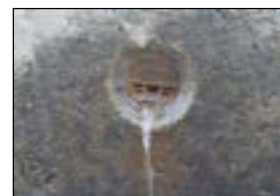
写真-23 流出状況
