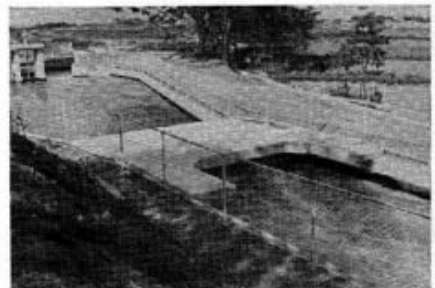
写真—4 波返しを取付けた消波工の一事例(上流側から見る)
