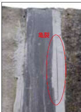
写真-16 樹脂の亀裂
