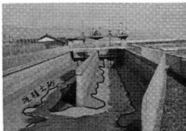
写真一1 舟底型沈砂池の落水後の状況
