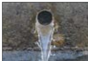
写真-21 流出状況
