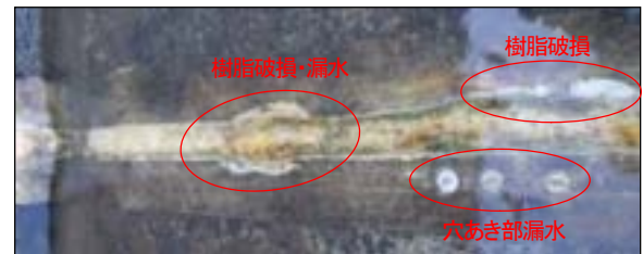
写真-13 底版部の漏水
