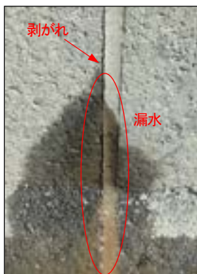
写真-5 ハンチ部漏水
