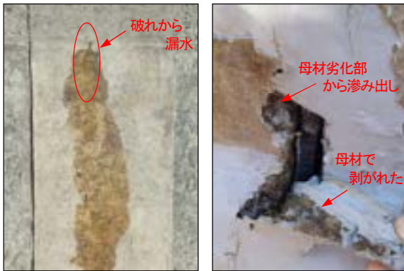
写真-9 ハンチ部漏水
