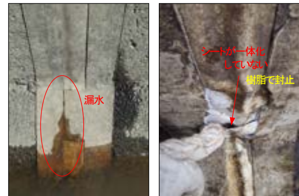
写真-14 ハンチ部漏水
