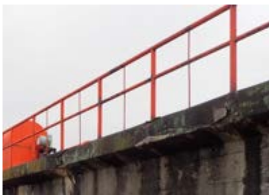
写真 7.3.2 凍結膨張による破壊
