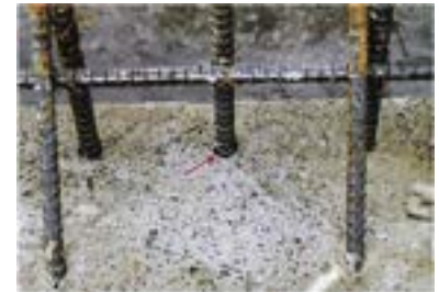
写真 3.6.14 鉄筋周囲の空洞
