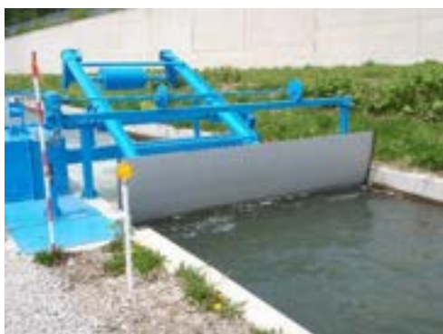
写真 6.2.6 自動ゲート上流側
