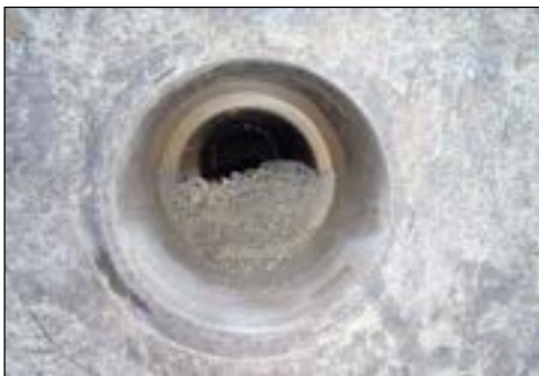
写真 3.9.11 土砂堆積状況
