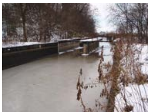
写真 8.4.2 水路橋上流開水路区間の結氷
