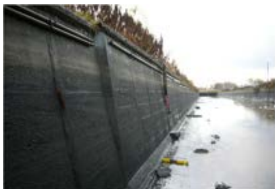
写真 3.8.1 凍上力による水路側壁の被害例
