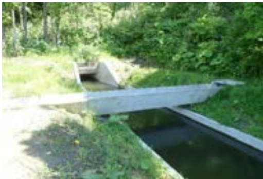
写真 7.2.1 オーバーシュート(フルーム型式)
