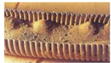
写真 3.9.4 管内に堆積した土粒子
