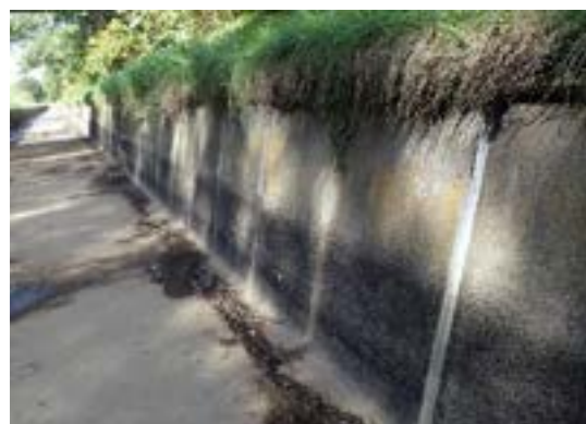
写真 3.8.2 凍上力による水路側壁の被害例
