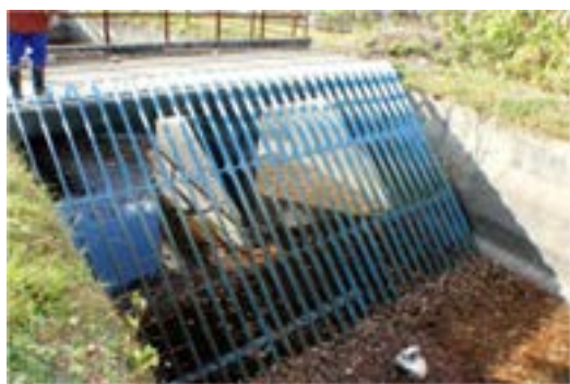
写真 7.5.3 鋼製バースクリーン
