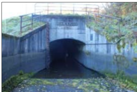
写真 8.4.1 トンネル区間の滞水
