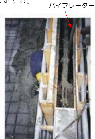
写真 3.1.11 部材厚 20cm の施工の悪い例
