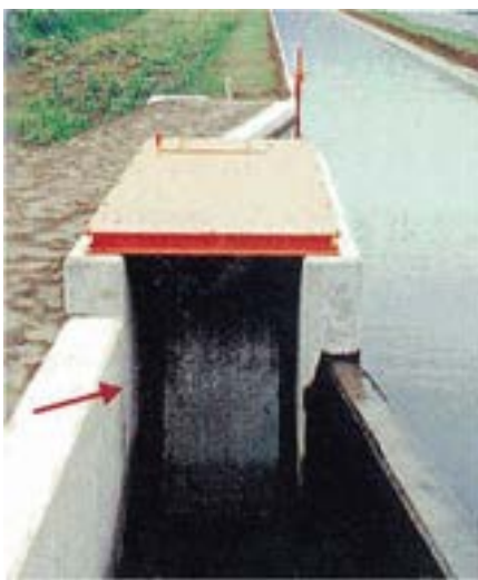
写真 6.3.5 初期の越流状態
